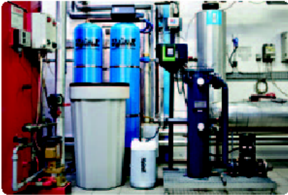
(Рис. 3) Полный комплект оборудования для водоподготовки для системы объемом до 1000 м³/час.
