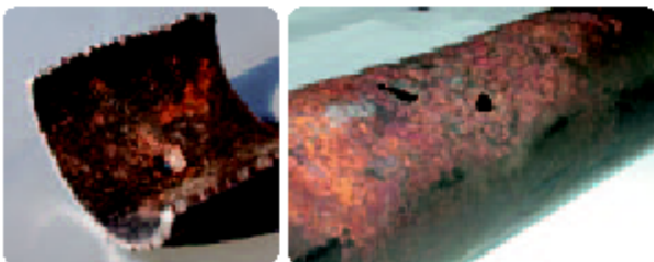
(Рис. 1.) Коррозия, связанная с локальными элементами, повреждает трубу
